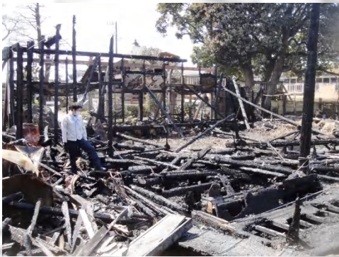
火災翌日の焼け跡の様子
